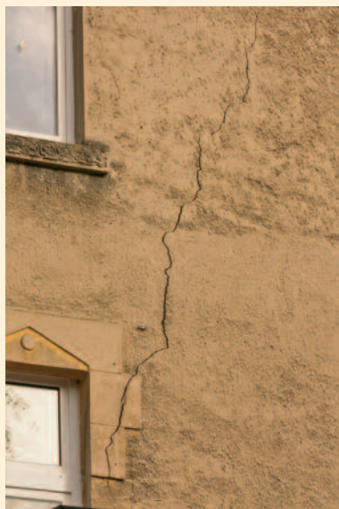
Breit aufklaffender Riss infolge Mauerwerksverspannungen und Dachschub.
