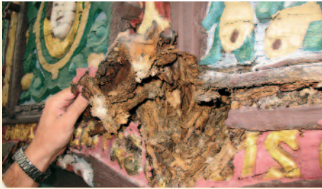
Durch Weißfäule zerstörte Fachwerkschwelle.
