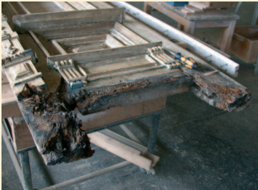
Schäden nach der Freilegung.
